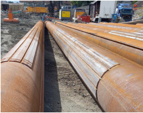
Abbildung 3-5: Verstärkungsbleche an den RD800 Pfählen
