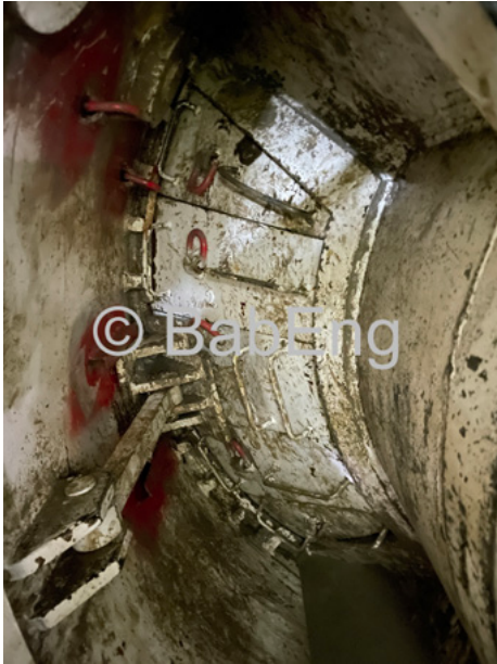
Abbildung 3-2: Zugang zu der Abbaukammer über eine Zugangsöffnung mit segmentierten Platten © BobEng
