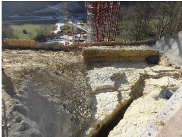
Abbildung 2-1: Baugrubensohle des Widerlagers des rechten Gleises Achse 10 mit mächtiger Störzone (Residuallehm bereits ausgehoben).
