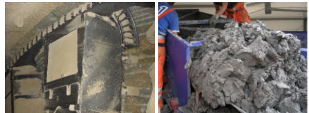
Abbildung 4.3: „verbackener“ Meißelkasten (links) und verstopfte Bandübergabe (rechts, Bild: Weh) am Katzenbergtunnel
